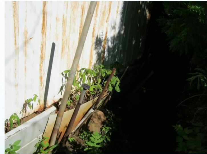
Remise à côté du ruisseau 2 menaçant de tomber
