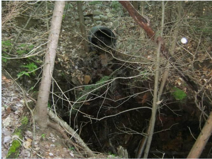
Ponceau 1 du tributaire 2 avec talus en érosion
